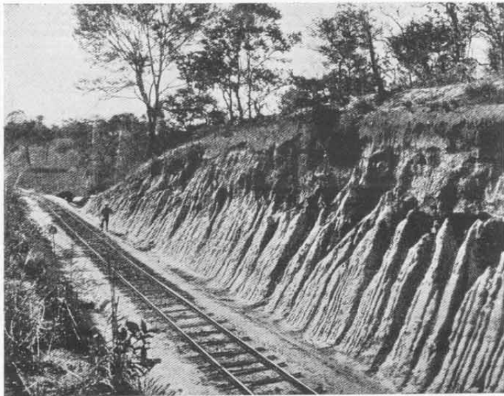
Abb. 81. Einwirkung des Regens auf die Böschungen. Tanganjikabahn.
